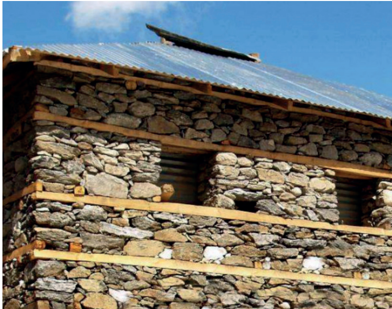
Figure 60 : photo d'une mise en oeuvre du système bhatar, crédit build back better.
